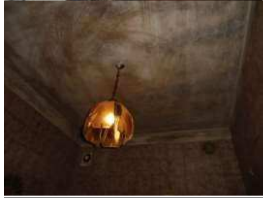
13-14 Umidità e muffa in cucina e bagno
