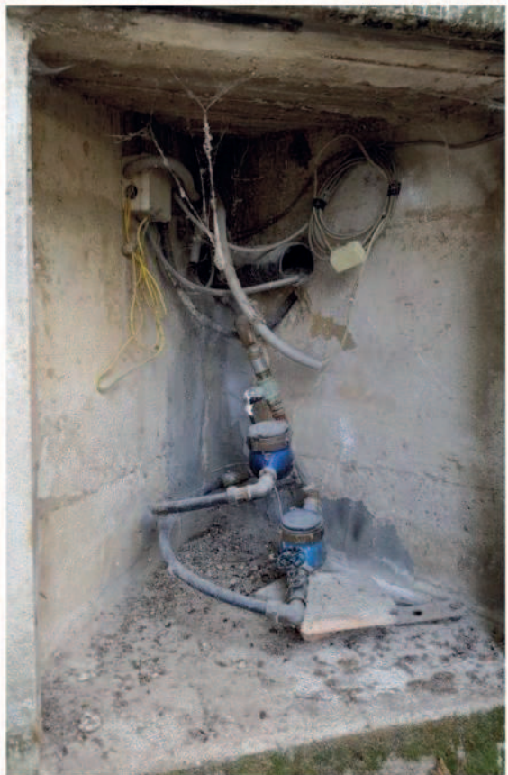
particolari impianti: GAS e H2O
