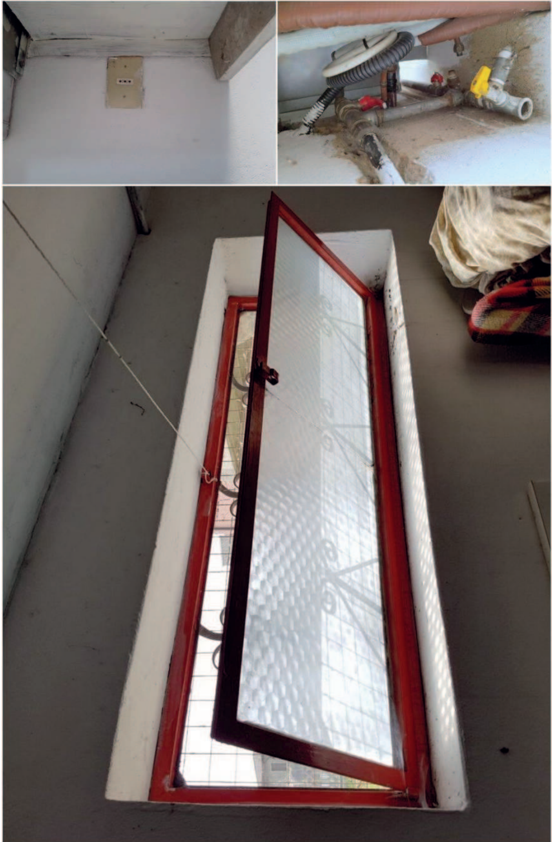
garage: particolari impianti
