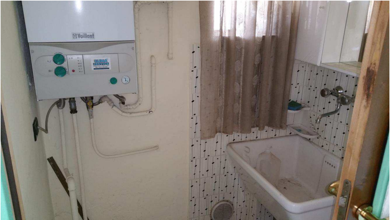
Foto n°15 – vista locale caldaia con lavabo
